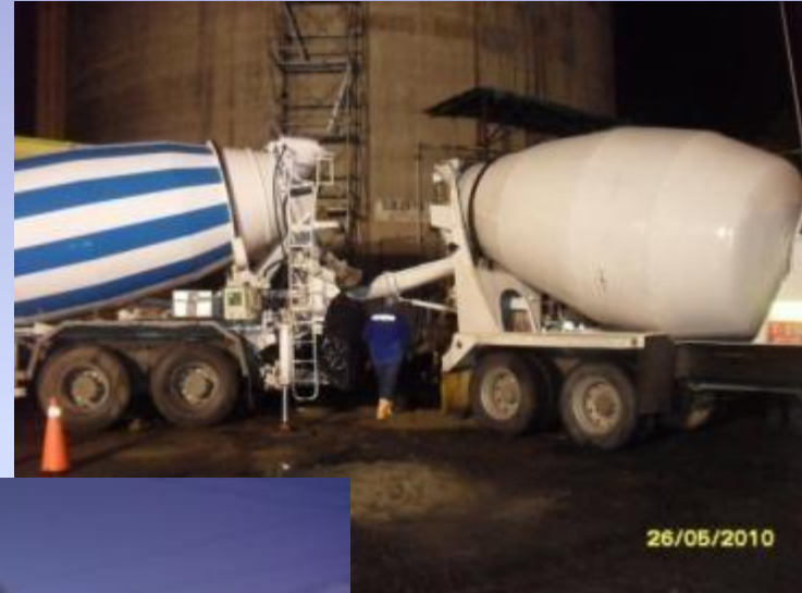
Equipo en operación
